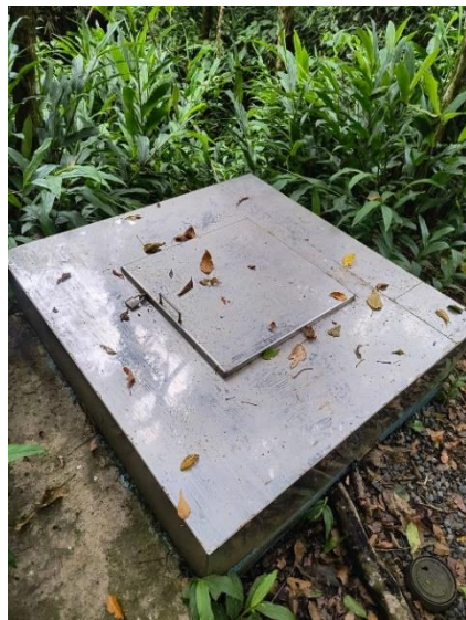
Caja de protección de Macro medidor
